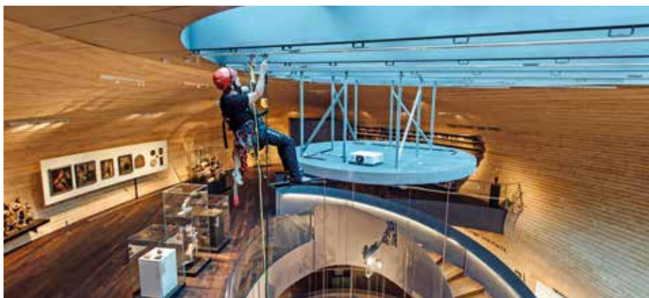
Im Innenraum des Gebäudes, dem Atrium, wird ebenfalls auf INNOTECH® Produkte vertraut: Eingehängt mit einem INNOTECH®-Taurus-Gleiter und ausgestattet mit einem Auffanggurt ermöglichen sechs TAURUS Schienensysteme einen sicheren Zugang zum Wartungspodest.
